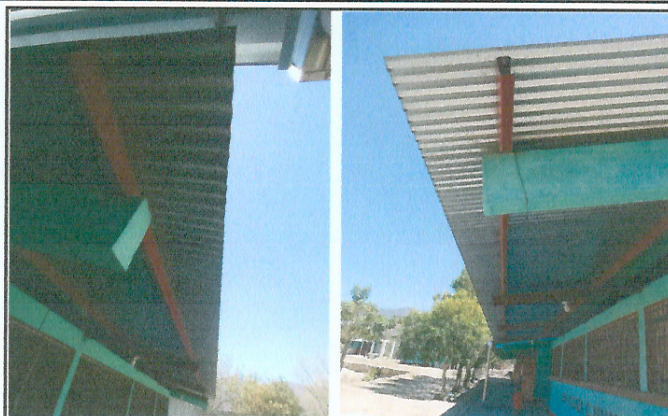
Foto 2 y 3: Mejoramiento de canales y bajada de agua pluvial en módulos de Preprimaria.
