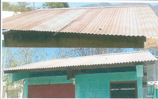
Foto 8: Requiere mejora de cocina y de techo a Lámina troquelada calibre 26.
